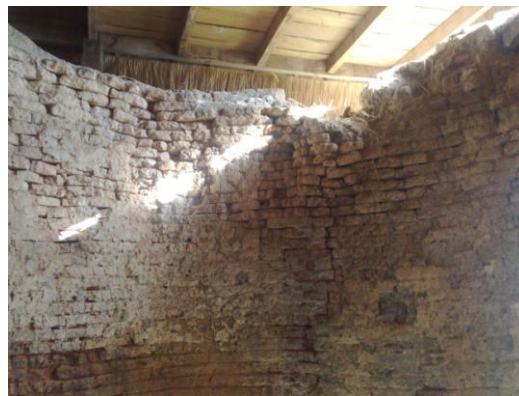
Figura 6 – Vista interna do forno [20]
