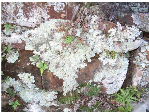
Figura 2: Se observa la presencia de líquenes y plantas sobre una pared perteneciente a las Ruinas de San Ignacio Miní, Misiones.
