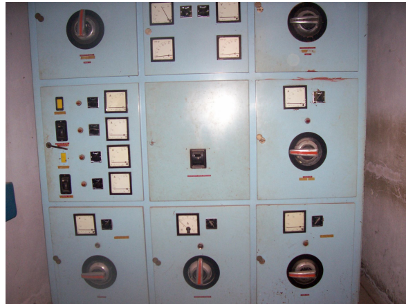
Foto 14: Tablero de Control
