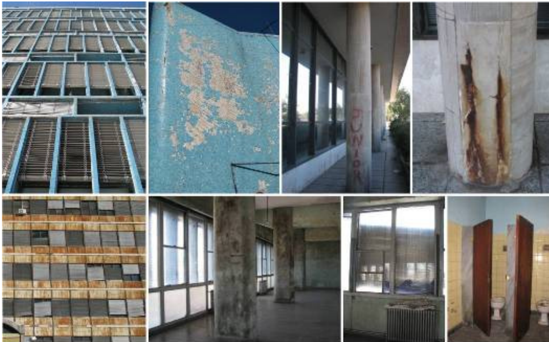
Figura 3 - Deterioros, edificio de Correos y Telecomunicaciones.
