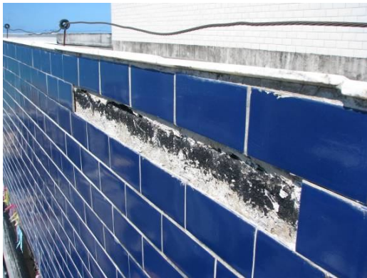
Foto 06 – Acervo do Autor – Exemplo de deficiência de detalhe de platibanda, com virada de impermeabilização (material asfáltico) na fachada, passando a comprometer a aderência dos revestimentos cerâmicos.
