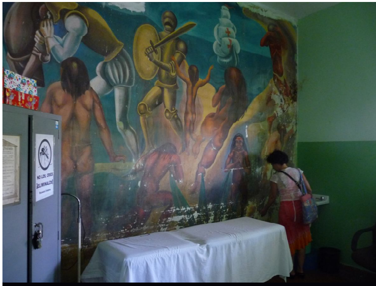
Fotografía 3. Los murales del primer piso representan escenas de la historia nacional, como éste de la Conquista, en el Dispensario Médico. Viviana Domínguez observa el daño causado por el roce del mobiliario.
