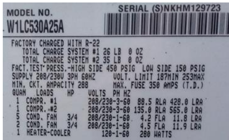
Figura 49. Datos de placa del chiller actualmente instalado.
