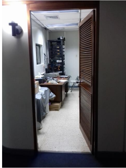
Figura 40. Interior de la cabina de control.
