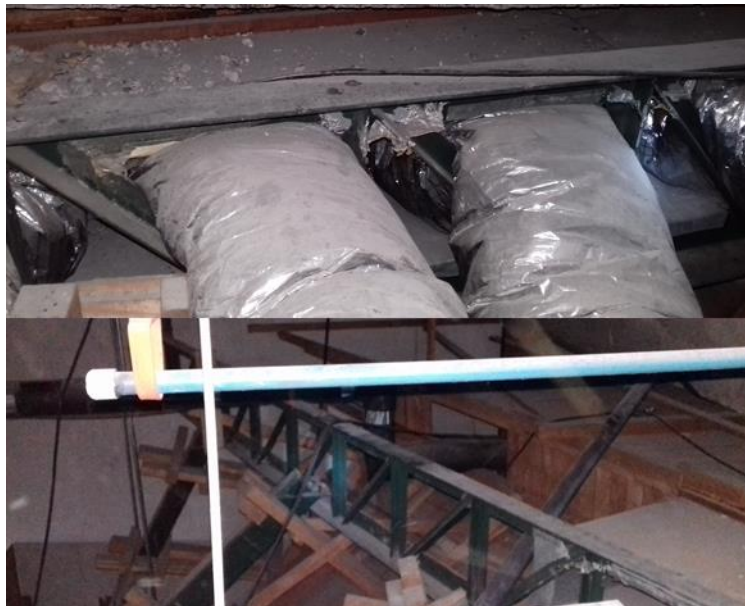
Figura 79. Detalle de ductos de suministro sobre el escenario.
