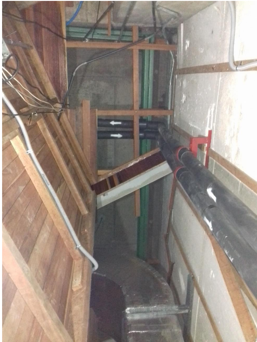
Figura 82. Detalle de altura de la red de tuberías en la manejadora 3.
