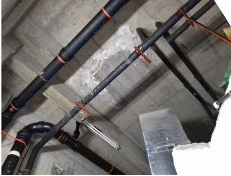
Figura 42. Sistema de tuberías que se ubica detrás del escenario.
