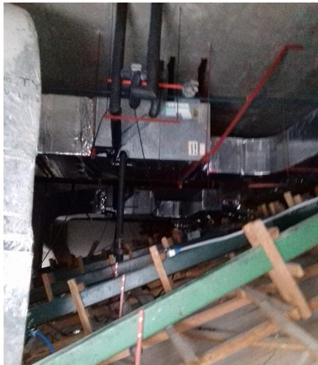
Figura 43. Manejadora de aire ubicada sobre el escenario dentro del cielorraso.
