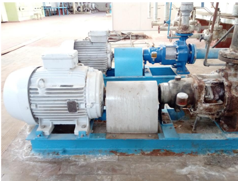
Figura 35 - Bomba para Tratamento de Água (B 501 B)
