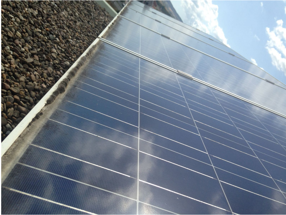
Figura 3.1: Efeito da infiltração de umidade no módulo, resultando em crescimento de musgos no encapsulamento.
