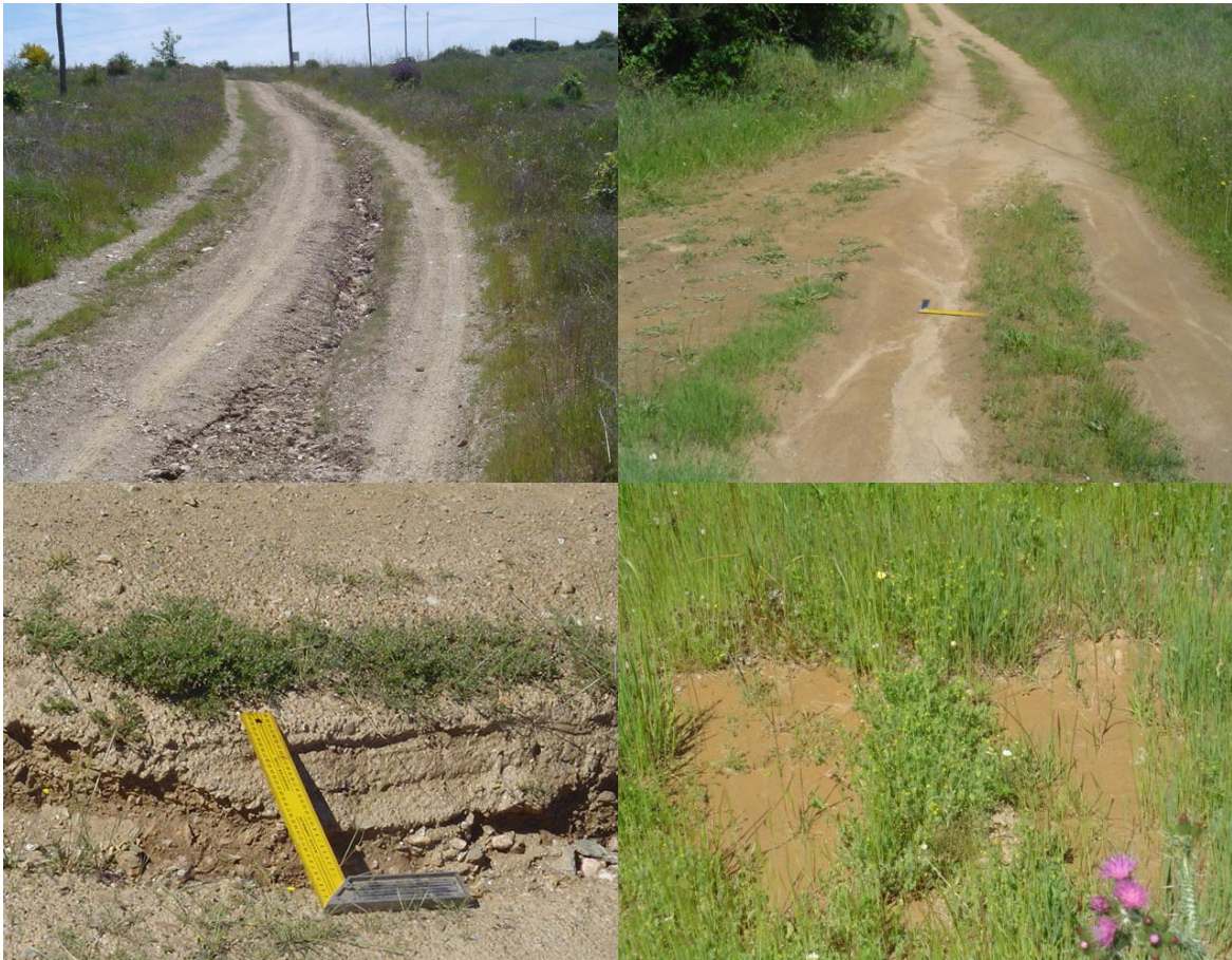
Figura 3.2.25 – Efeitos do processo erosivo na rede viária dois anos após a instalação do ensaio experimental.
