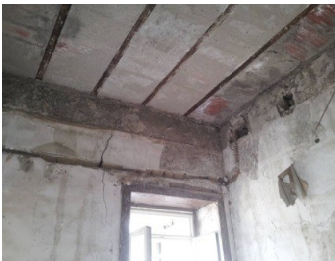
Figura 1.11 Lesione nel paramento murario a seguito di intervento di rifacimento del solaio con cambiamento di orditura.
