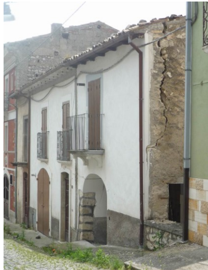
Figura 1.3 Quadro fessurativo per meccanismo di ribaltamento semplice
