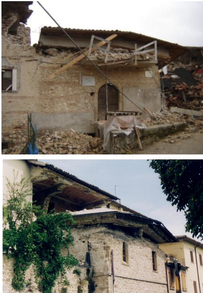
Figura 1.12 Danni da sostituzione di copertura.
