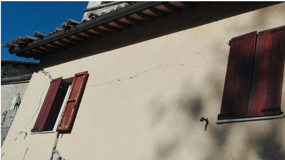
Figura 5.40 Meccanismi di collasso edifici esistenti a seguito degli eventi sismici del 24 agosto 2016 nel Centro Italia
