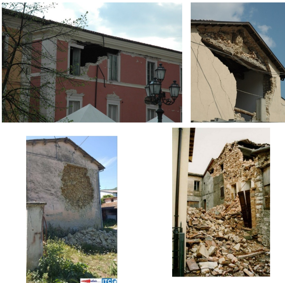
Figura 1.1 Foto di meccanismi di collasso per disgregazione della muratura
