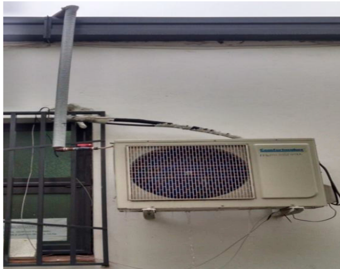
Figura 2: Fotografía del sistema de climatización y adaptación del recurso geotérmico
