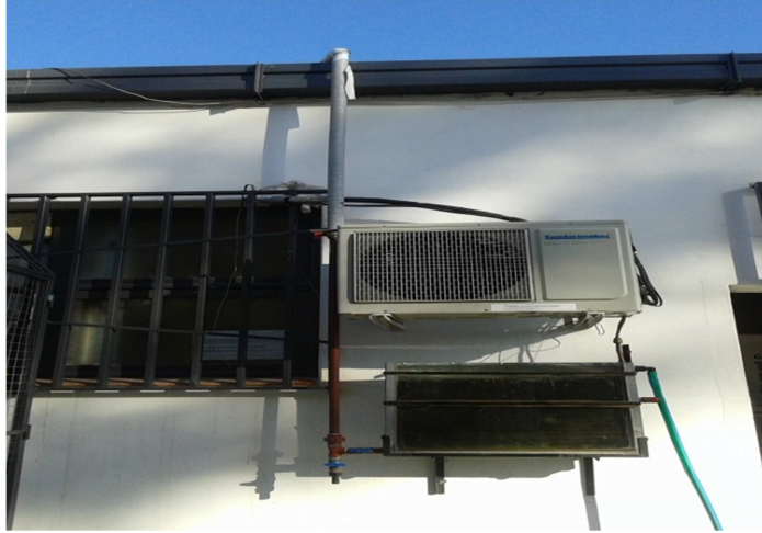
Figura 7: Fotografía del sistema de climatización y evaporador sumergido
