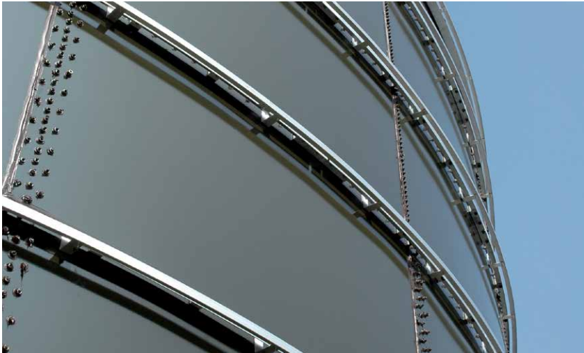
Der Wärmespeicher setzt sich aus modularen Stahlsegmenten zusammen. Foto: Thorsten Urbaneck
