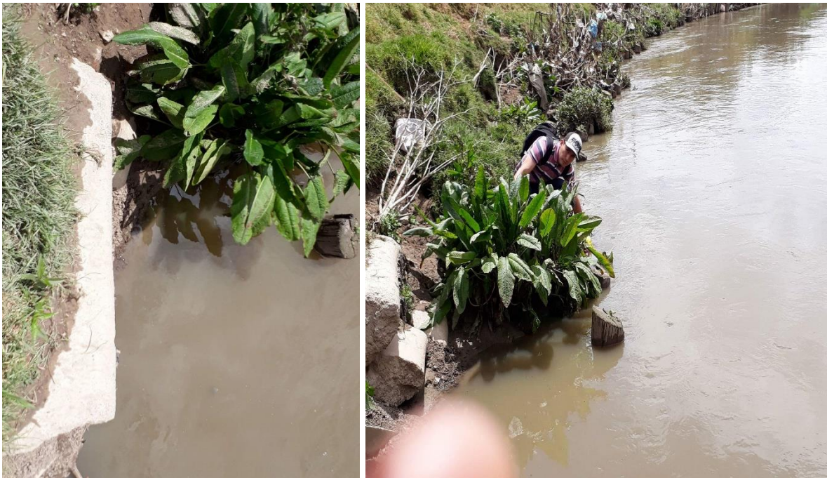
Imagen n° 6 Identificación de punto de conexión errada (producción propia)
