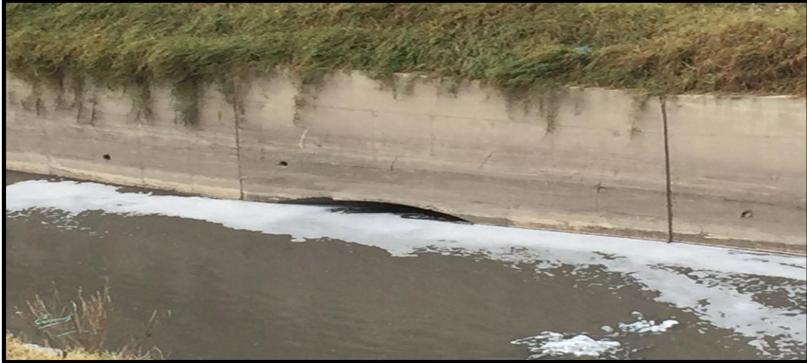
Ilustración 4. Descarga Colector 1 En Quebrada Chiguaza
