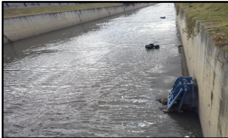
Ilustración 5. Descarga Colector 2 En Quebrada Chiguaza
