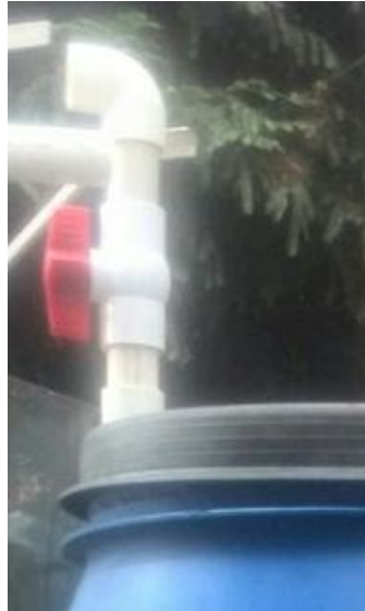
Ilustración 32. Tubería de efluente
