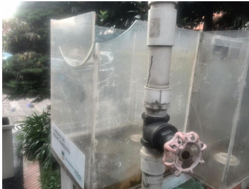
Ilustración 56. Cámara de aquietamiento
