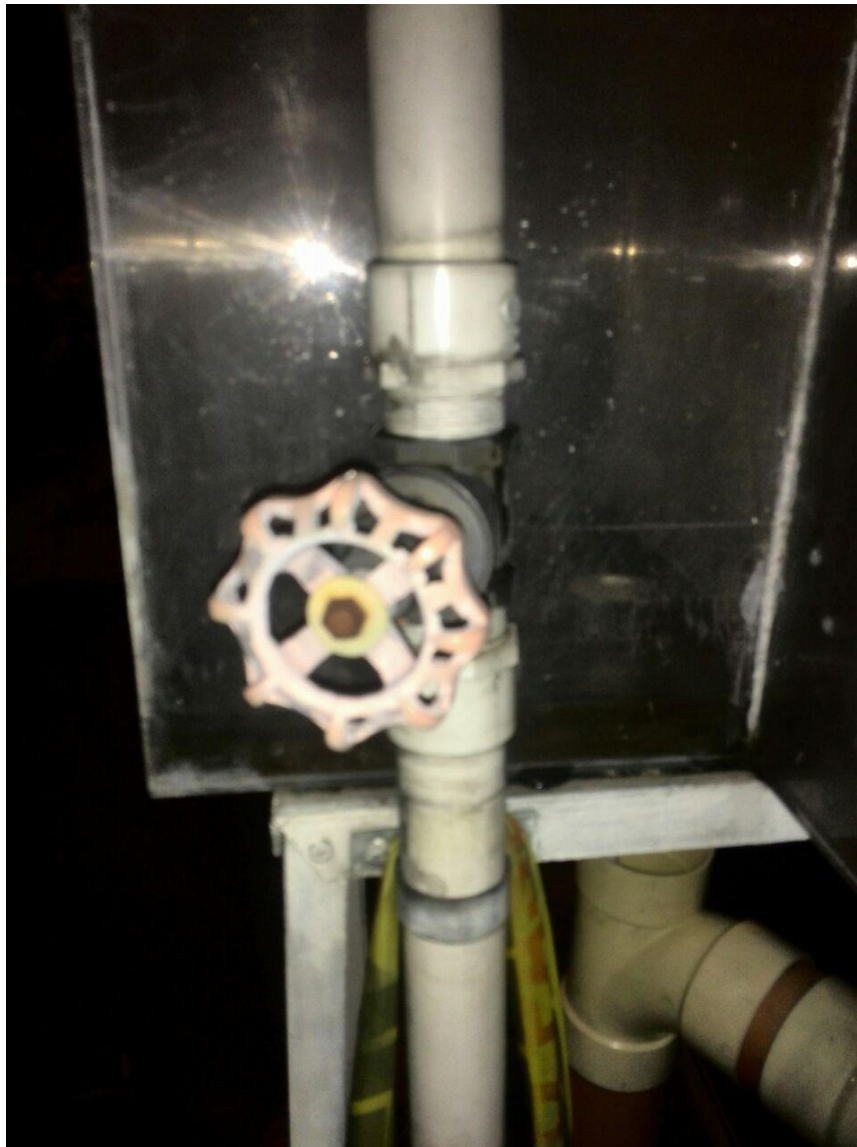
Ilustración 43. Registro de planta de aguas lluvias, Universidad Católica de Colombia
