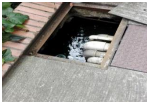
Ilustración 55. Tanque de almacenamiento
