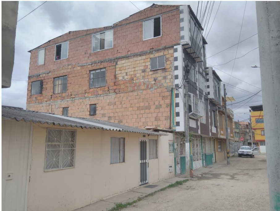
Ilustración 44 Fotografía demostrando la materialidad de la envolvente de la vivienda. Toma propia 2017.
