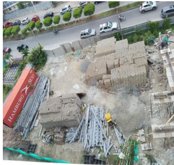
Fuente: El Autor. Figura 14. Desperdicio de Bloque sector 2.
