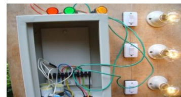
Gb 15. Pengujian listrik pada panel
