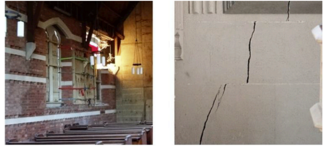
Figura 12. Immagini del danno associato alla risposta nel piano della navata laterale.
