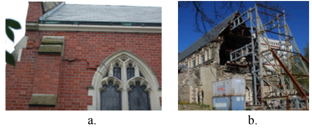
Figura 7. Esempio di danno longitudinale: a) nel piano delle pareti laterali della navata; b) fuori dal piano della facciata.
