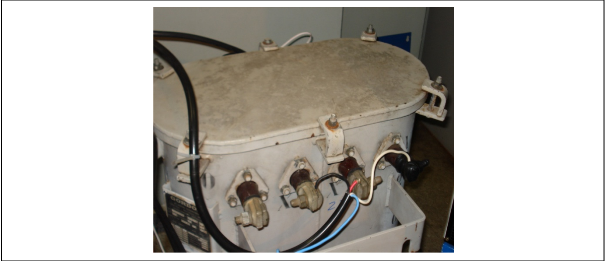
Figura 35a – Conexão (entrada) da rede trifásica (220 V) ao transformador elevador
