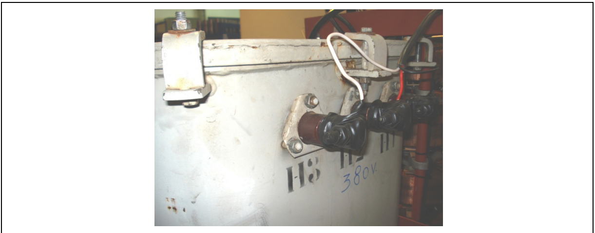
Figura 35b – Conexão (saída) do transformador trifásico (380 V) ao regulador de tensão trifásico
