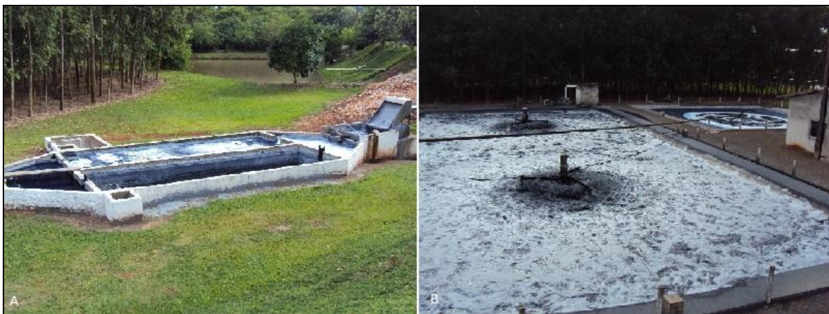
Figura 5 – Imagem da estação de tratamento de efluentes têxteis a) caixa de entrada; b) vista parcial do sistema de tratamento.
