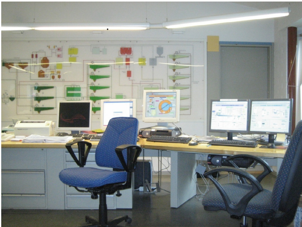
Kuva 4. Rovaniemen jätevedenpuhdistamon valvomo.
