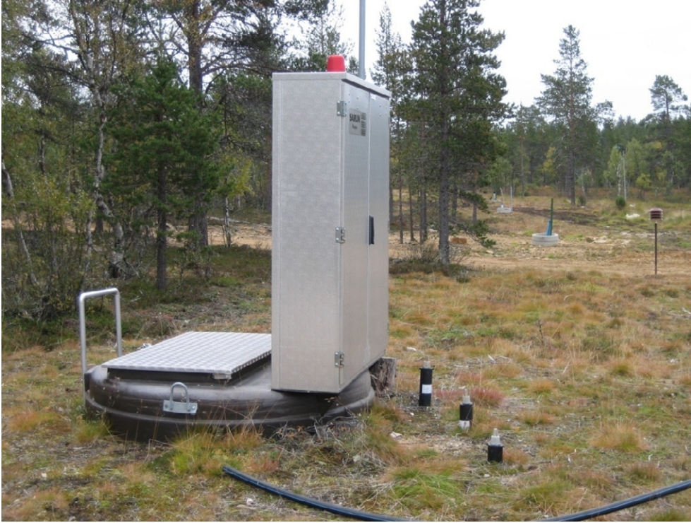
Kuva 9. Jätevesipumppaamo Saariselän matkailualueella.
