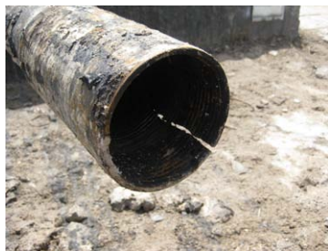
图4 隔热油管联接螺纹处的破裂照片
