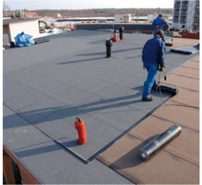
Kuva 4. Riittävä kallistus, oikea materiaalit ja huolellinen työ varmistavat vesikatolle pitkäikäisen vedenpitävyyden /Juha Sarkkinen/.
