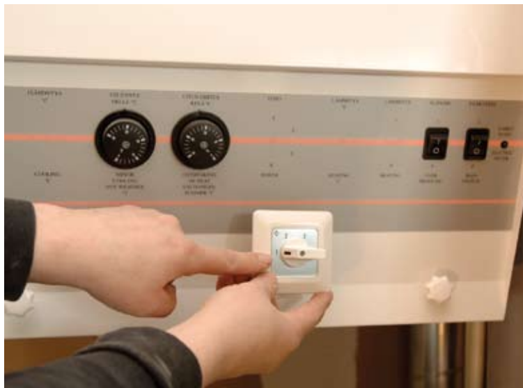
Kuva 12. Ilmanvaihtokoneen pitää toimia vähintään minimi-ilmanvaihdolla. Koneetta ei saa sammuttaa /Juha Sarkkinen/.
