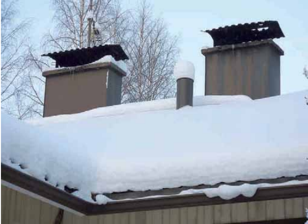
Kuva 26. Huonosti eristetty tuuletusviemäri huurtuu umpeen kovalla pakkasella ja päälle satanut lumi voi silloin tukkia sen kokonaan.
