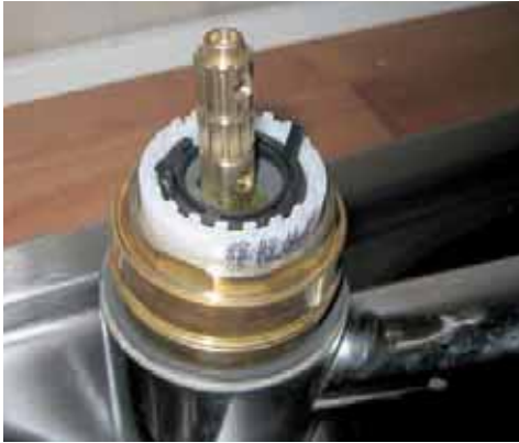
Kuva 68. Käyttövipu ja suojakuppi on irrotettu.
