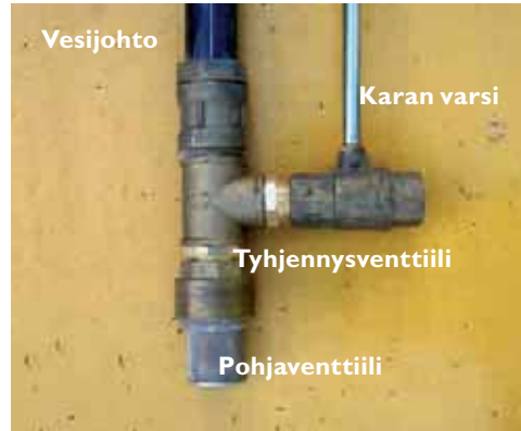
Kuva 5. Vedenpinnan ollessa kaivossa vesijohtoon läpiviennin kohdalla, vesijohto on vaarassa jäätymä pakkasella läpiviennin kohdalta.
