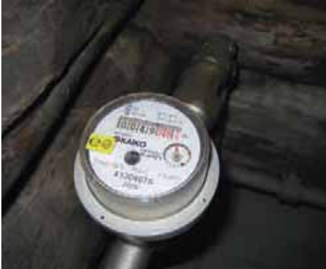
Kuva 11. Vesimittari lämpimässä tilassa rakennuksen sisällä.
