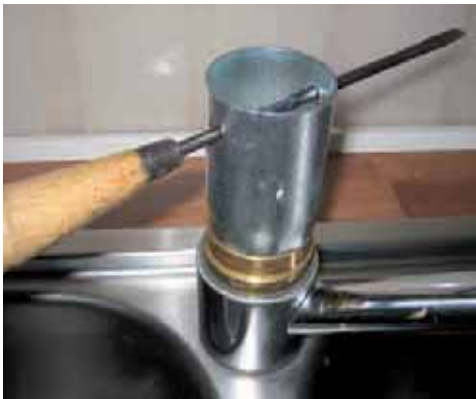
Kuva 69. Säättöosan kiristysmutterin irrotus. Irrotuksessa tarvittava 38 mm:n avain on erikoistyökalu, joka on syytä hankkia valmiiksi hanan oston yhteydessä.
