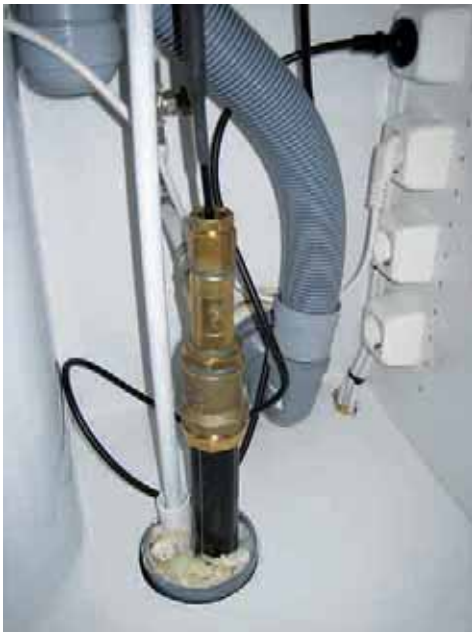
Kuva 12. Mökin keittiöön ulkoa tuleva vesijohto on varustettu putken sisään asennetulla itsesäätyvällä lämmityskaapelilla.
