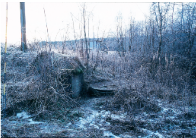
Kuva 6. Kaivo on rakennettu virheellisesti: kaivon ympäristön pitää olla siisti; kaivon rakenteiden on ulotuttava reilusti maanpinnan yläpuolelle ja kaivossa on oltava ilmanvaihto järjestetty.
