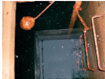
Kuva 2. Vesisäiliön rakenteet ovat syöpyneet, koska veden pH on alhainen.
