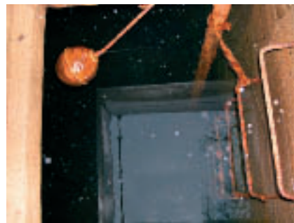
Bild 2. Vattentanken har korroderat p.g.a. att vattnet har ett lågt pH.
