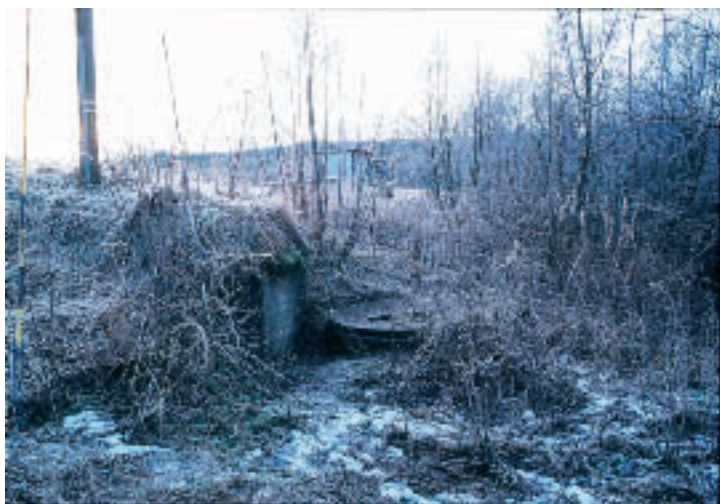
Bild 6. Brunnen är fel byggd: omgivningen bör vara snyggt hållen, brunnskonstruktionen skall höja sig rejält över markytan och brunnen skall ha fungerande ventilation.
