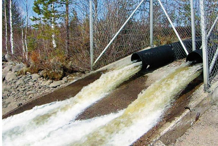
Neitikosken padon pumppuaseman purkuputket (Kuva: Seppo Hellsten).
