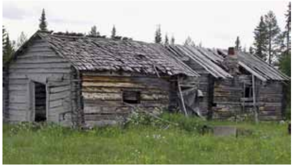
Kuva 72. Mäkimaan navetta on päässyt huonoon kuntoon. LKYT 2005.
