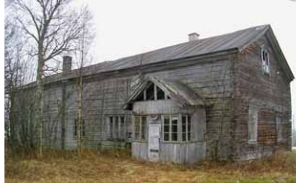
Kuva 106. Keskitalon huonoon kuntoon päässyt päärakennus. LKYT 2004.
