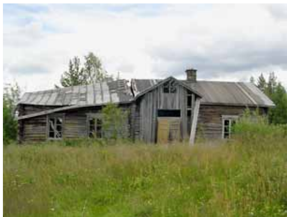
Kuva 141. Tyhjilleen jäävät rakennukset joutuvat varsin nopeasti huonoon kuntoon ja niiden pihapiirit puskittuvat. LKYT 2005.
