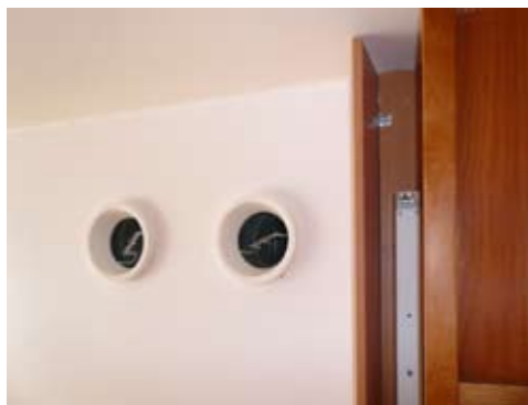
Kuva 3. Ilmanvaihtokanavan suojalevyt on revitty irti.
