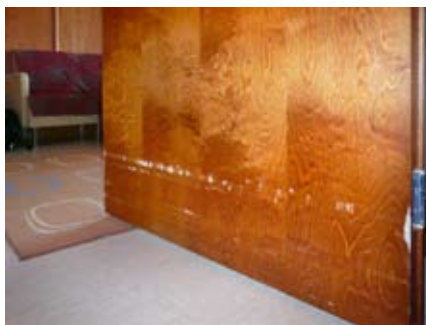
Kuva 7. Ovessa näkyy pyörätuolin aiheuttamia kolhuja.
