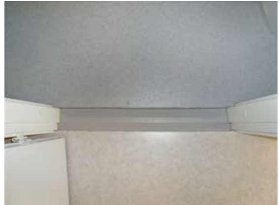
Kuva 2. Kylpyhuoneen lattia on märkätilojen muovimattoa. Huoneen lattia on tavallista muovimattoa ja on märkänä liukas.
