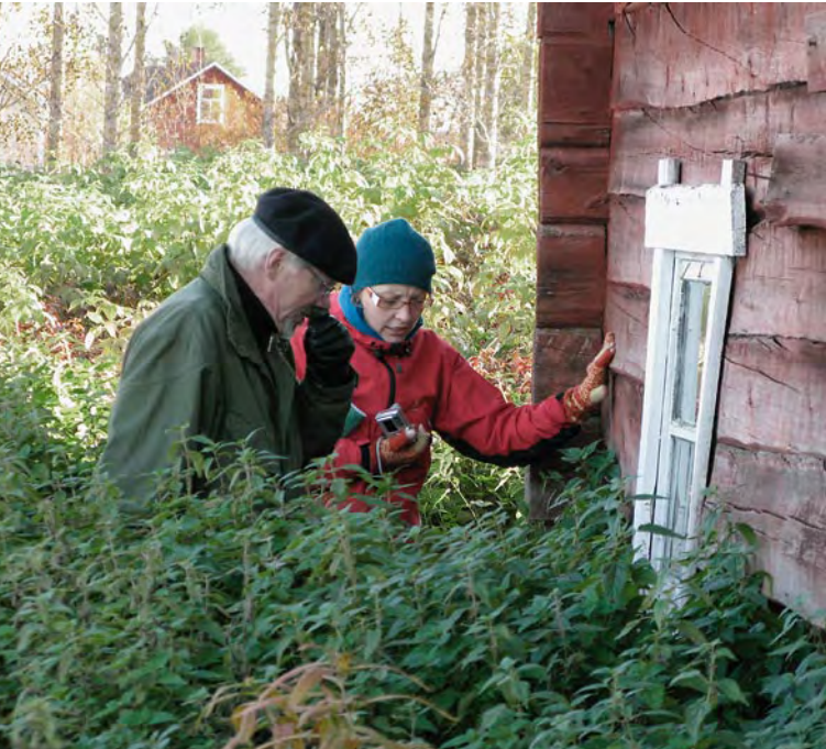
Kuva 50. Korkea kasvillisuus seinän vieressä estää ilman kiertämisen rakennuksen alapohjassa. Kuva Marjut Kokko.
