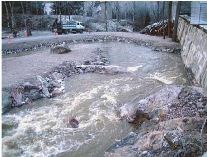
Kuva 1. Siuntionjoen Sägarsforsin käytöstä poistetun voimalaitoksen viereen on rakennettu monimuotoinen ohitusuoma, johon tehty myös lisääntymisalueita taimenelle. Korkeusero on 8,5 m, uoman pituus 250 m ja kaltevuus 3,4 %. Uoma on mitoitettu virtaamalle 2 m 3 /s. Kuva: Jukka Jormola
