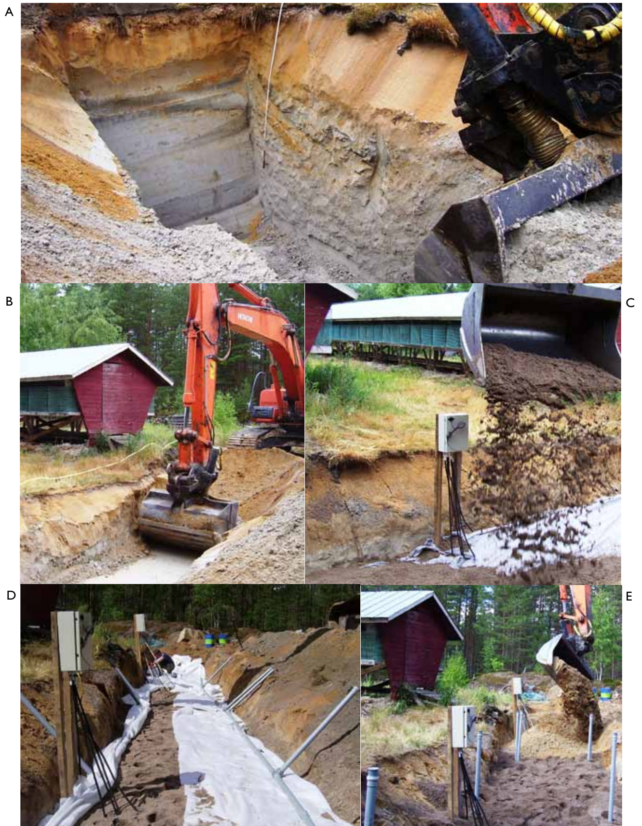
Kuva II. Hiilenlähteen imeytysputkiston rakentamisen eri työvaiheita: A) ja B) kaivannon teko, kuvassa A näkyy selvästi maalajin vaihtuminen pintamaan hiekasta metrin syvyydeltä alkaen siltiksi C) suodatinkankaan asetus ja sorakerroksen levitys, D) putkiston kokoaminen ja E) sorakerroksen levitys. (Kuvat: Sanna Petäjäjärvi)
