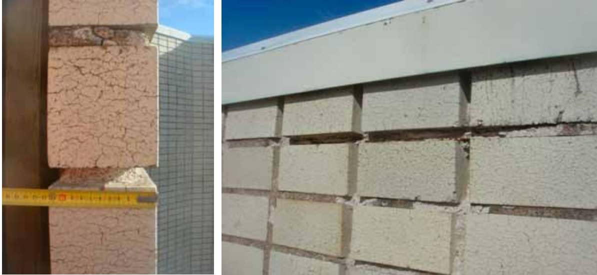
Kuva 16. Kuorimuurin laastin pakkasrapautumisen seurauksena muurin jännitystila ja hoikkuus kasvavat, mikä on otettava huomioon kantavuustarkasteluissa. Kuorimuurin raudoitteiden korrosio rikkoo laastipeitettä aina 20 mm:n syvyydeltä saakka.
