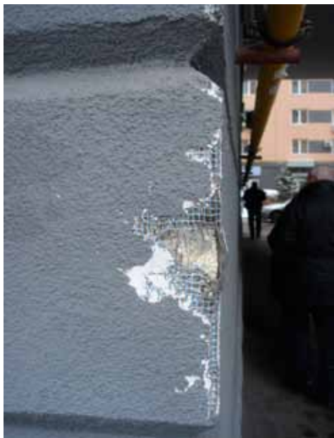
Kuva 18. Eristerappauksen nurkka on vaurioitunut kolhun seurauksena.
