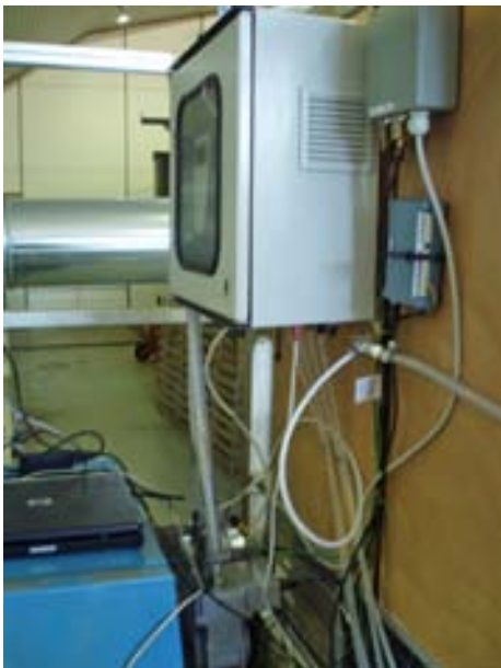
Kuva 6. Kiinteästi asennetut kaasun virtaus- ja koostumusmittarit. Kuva: Tuula Kajolinna
