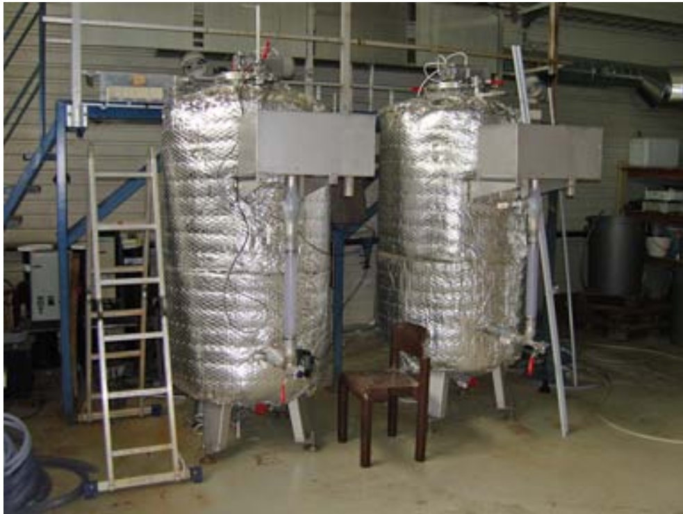
Kuva 3. Reaktorit ilman suojatelttaa. Kuva: Ari Kangas
