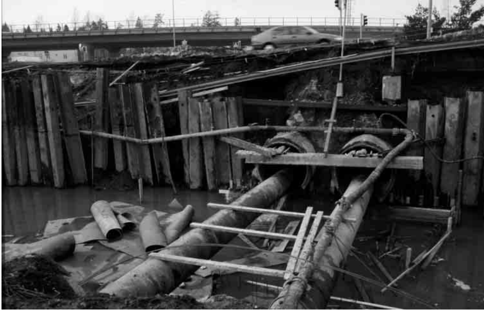
Kuva 82. Mellunkylänpuroa siirretään viemäriin Mellunkylän metroaseman eteläpuolella keväällä 1999. Kuvassa näkyy osin sortunut tiepenger.
