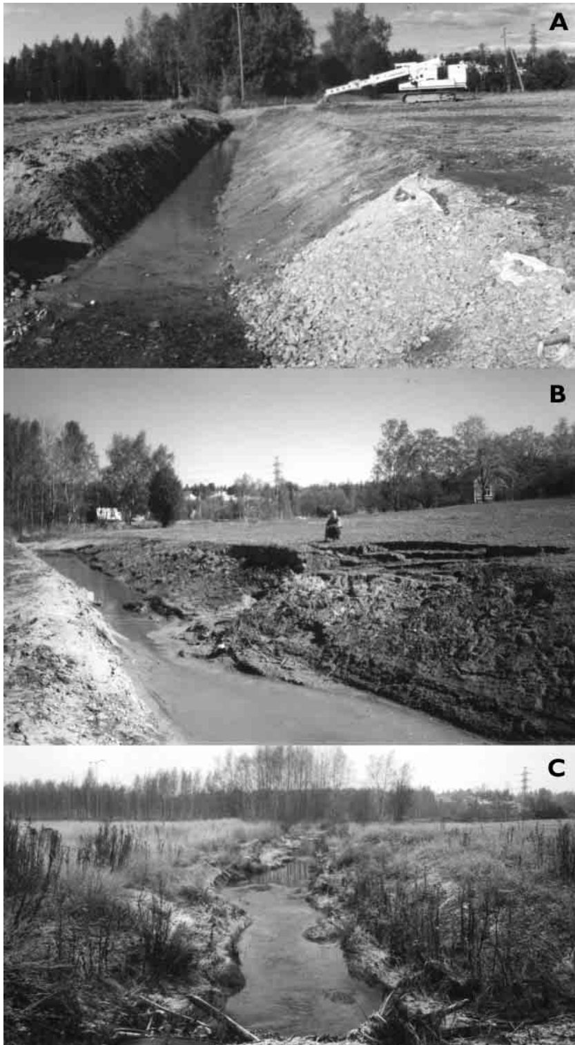
Kuva 90. (A) Mellunkylänpuron pääuoman oikaisutyöt käynnissä Itäväylän eteläpuolella syyskuussa 1995. (B) Huhtikuussa 1996 eroosio oli selvästi leventänyt uoma. Savikon alaisesta hiekkakerrostumasta pääsi purkautumaan pohjavettä, mikä aiheutti kuvassa näkyvän maanvieremän. (C) Syksyllä 1998 purouoma on yli kolme kertaa alkuperäisen kaivetun uoman levyinen ja alkanut meanderoida. Pellolle on myöhemmin rakennettu Vartiokylän teollisuusalue ja paloasema. Kuvat (A) ja (B) Turo Ketola; (C) Olli Ruth.
