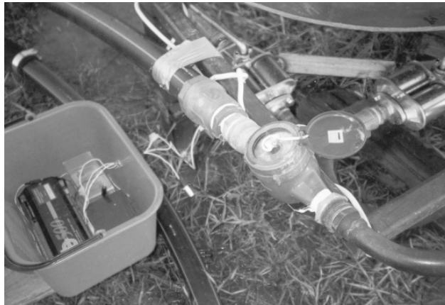
Kuva 24. Loggeri, vesimittari ja kaksi Nira 6b pumppua asennettuina.
