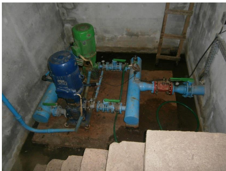
Figura 4.3 – Estação de bombagem do campo de golfe.
