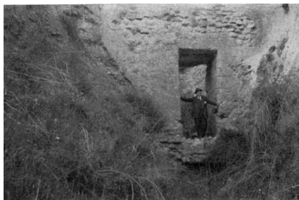
LÁM. 13: Substructio del acueducto con vano central adintelado. Barranco de La Umbría del Moral III. Tramo VI. Foto: Fernández Casado (1972).
