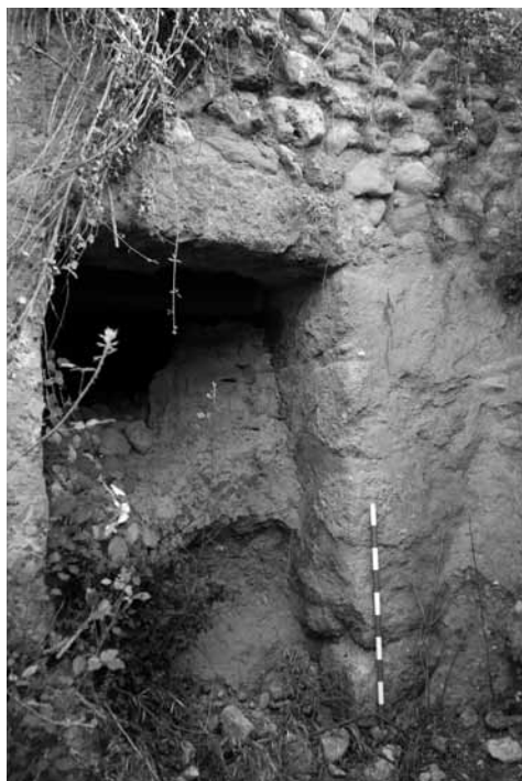
LÁM. 12: Substructio del acueducto con vano central adintelado. Barranco de La Umbría del Moral III. Tramo VI.
