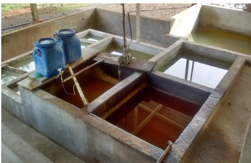
Figura 34 – Estação de tratamento de efluentes da empresa
