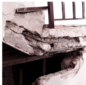
2.11. Recubrimiento escaso de hormigón
