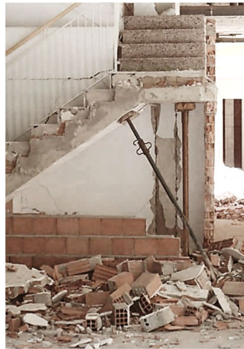
2.10. Fallo en la estructura resistente escalera
