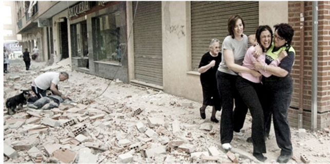
2.14. Una de las víctimas, aplastada tras el derrumbe de una fachada
