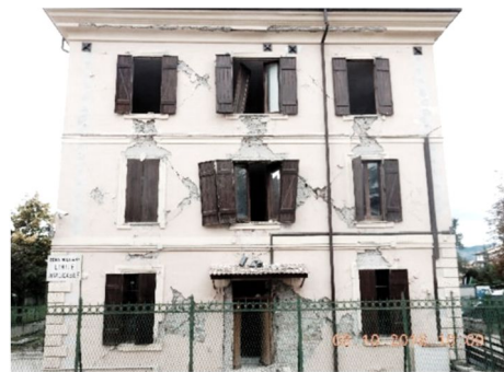
2.17. Grietas diagonales en muros de fábrica resistente
