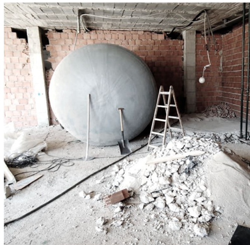
2.6. Sobrecarga debida a la colocación de un depósito no previsto
