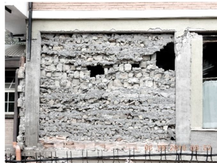
2.15. Daños en paños de relleno
