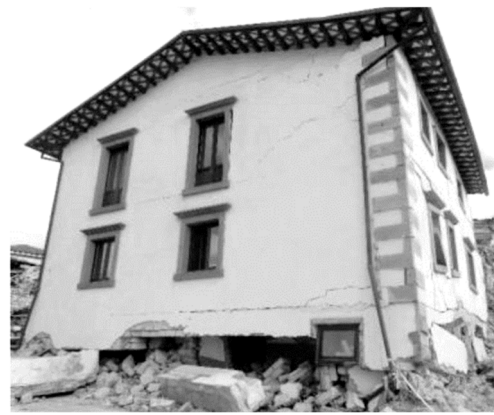
2.19. Colapso parcial tras una segunda sacudida
