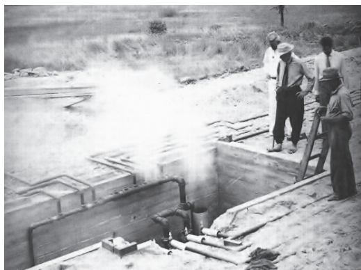
Figura 5 Fotografía tomada durante las pruebas de funcionamiento del sistema de calefacción «Gravity Heat» (Jacobs 1978, 28)
