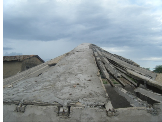
Figura 19. Rotura de viguetas de cubierta.
