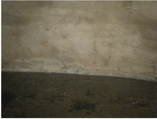
Figura 18. Fisuras en fondo y pared.
