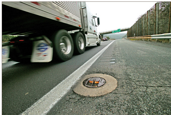
Luz empotrada de señalización de borde de calzada.
