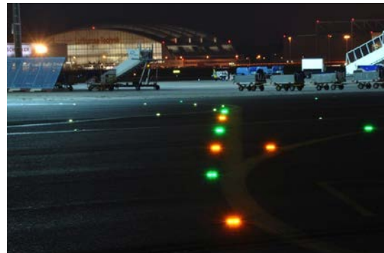
Luces de eje de calle de rodaje en plataforma de estacionamiento de aeronaves.
