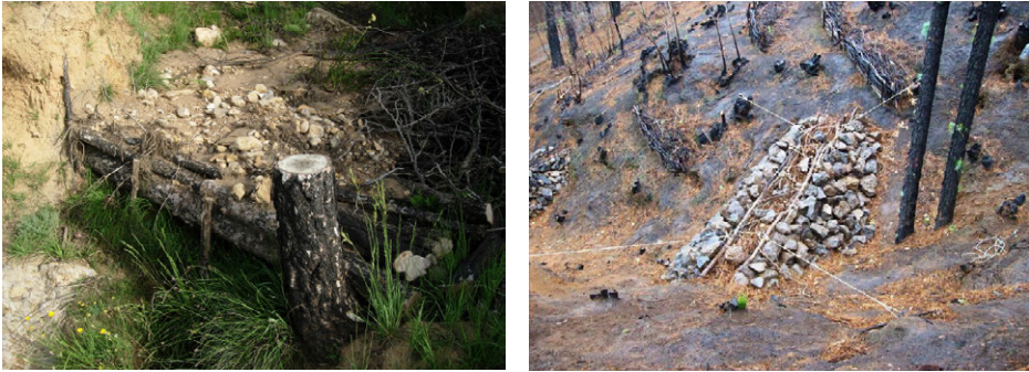
Figura 11.15: A la izquierda, albarrada convencional, hecha de troncos, y con la cuña de sedimentos ya formada (Foto: A. Hernández). A la derecha, ‘fajina armada’ (albarrada de mampostería en seco con una matriz de restos vegetales) (Tardío y Caballero, 2008).
