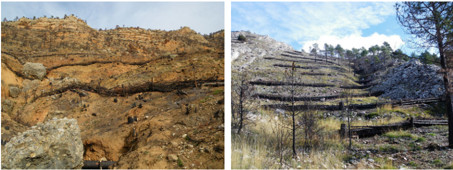
Figura 11.14: Obras de restauración de laderas afectadas por el incendio forestal de Aliaga y Ejulve (Teruel) . A la izquierda, fajinas. A la derecha, empalizadas. (Fotos: A. Hernández).
