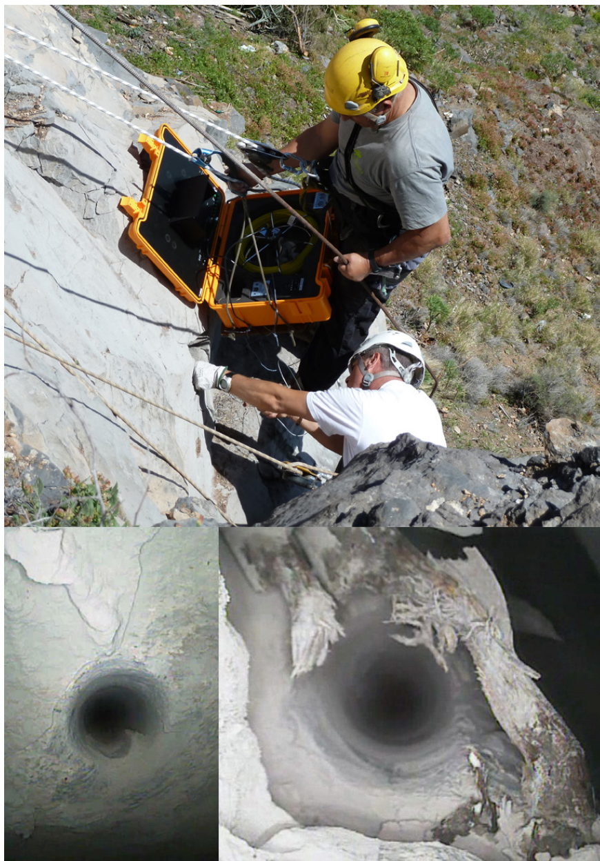
Figura 15.3: Auscultación digital de los sondeos horizontales. Se observa una grieta paralela al talud con apertura de 40 cm (Izda), y grietas con presencia de raíces (Dcha).
