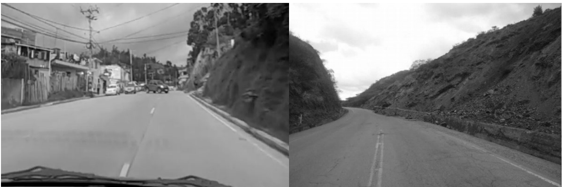
b) Falla de pintura asfáltica.
