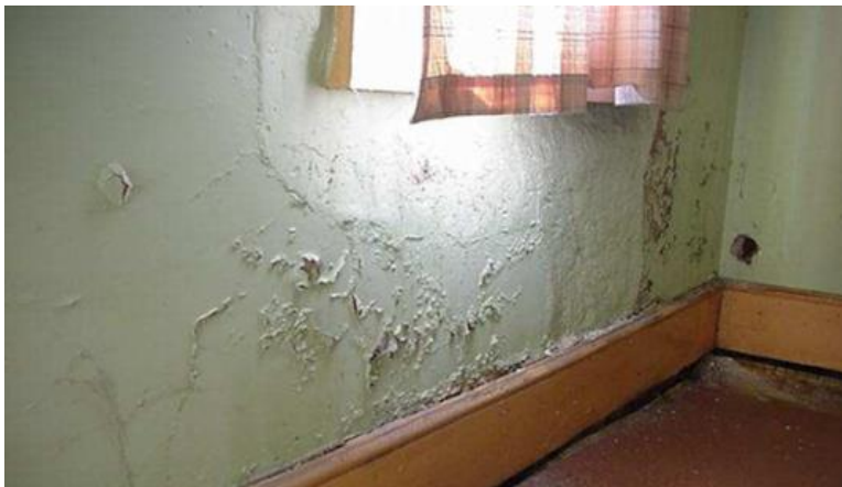
Dormitorio sin ventanas donde se puede apreciar el tamaño y la existencia de humedades y mohos
