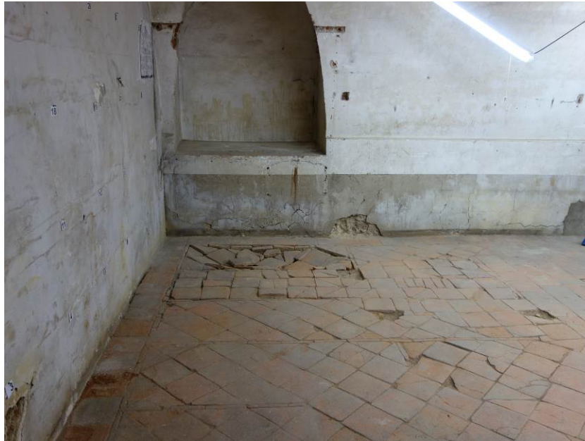
Foto 11. Pavimento, zona noreste. Encintando para un enterramiento, y hundimiento junto al arco-solio.
