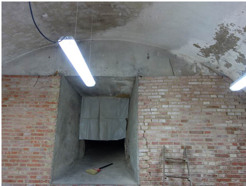
Foto 9. Ventanuco de ventilación a la calle de Las Huertas. La jamba derecha tiene una grieta vertical en toda su altura.
