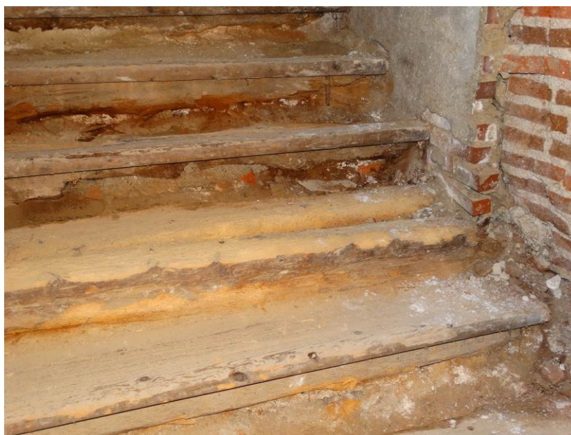
Foto 4. Detalle de los peldaños. Su degradación es consecuencia del contacto directo con el terreno y de la humedad natural de éste.
