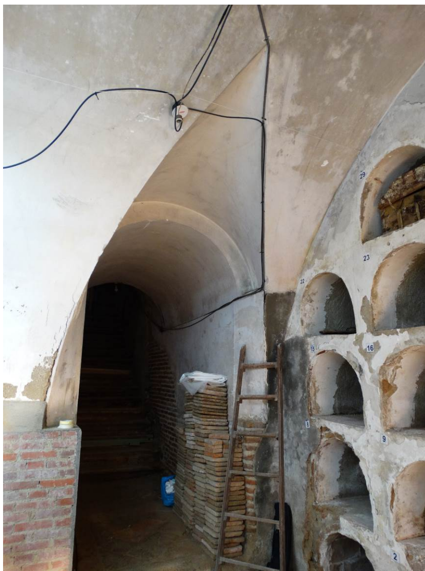
Foto 5. Luneto que forma el encuentro de la bóveda de la escalera con la de la cripta. Nótese el encuentro en ángulo agudo de sus aristas, y la pendiente de su directriz.
